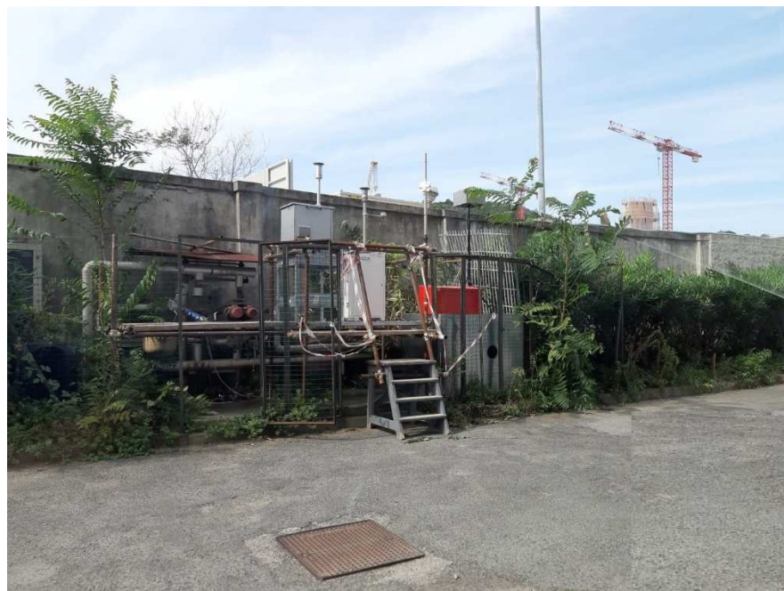
Figura 4 – Centraline Postazione ponente a Sud (44,425321 N; 8,885691 E) – PPS1 – A2
