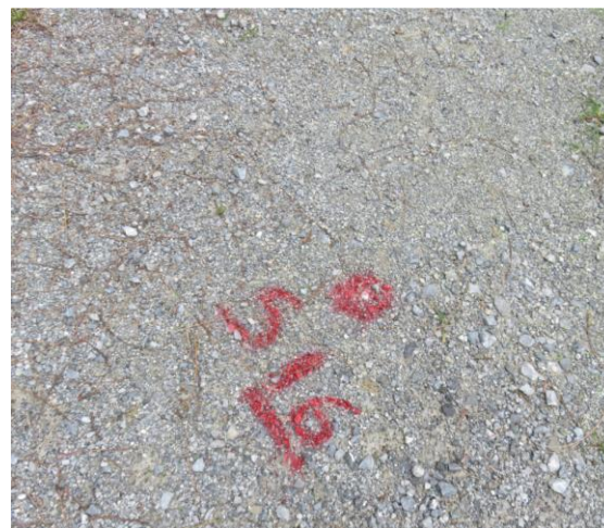
Figura 7-6 – Particolare del conglomerato bituminoso degradato nel piazzale
